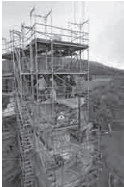
Die Baustelle auf der Ruine Peffingen zu besichtigen, war auch mit etwas Nervenkitzel verbunden. Es wagten sich dennoch viele in luftige Höhen.
